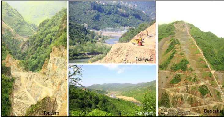
Foto 79: Havza Alanında HES, Yol Gibi Çalışmalardan Etkilenen Orman Alanları.
