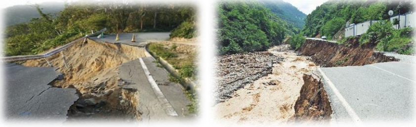
Şekil 3. 25. Yağış sonucu oluşan toprak kaymasının altyapıya verdiği hasar.
