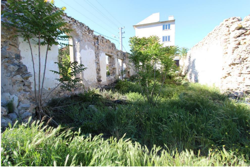
Fotoğraf 44: Davulga Eski Mektep Denilen Binanın İindeki Yıkılan Duvarlardan Kalan İzler
